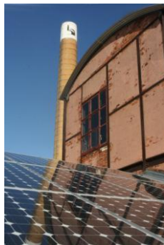
Photovoltaikanlage Brikettfabrik Louise Foto: Christian Weber
